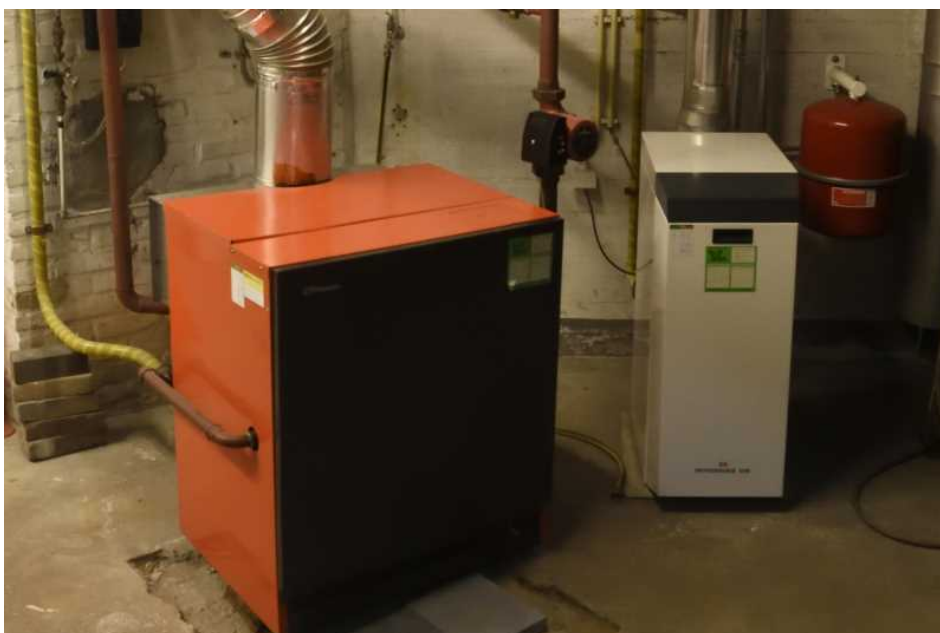
De verwarmingsketel van de kosterwoning (rechts) en de overige ruimten
